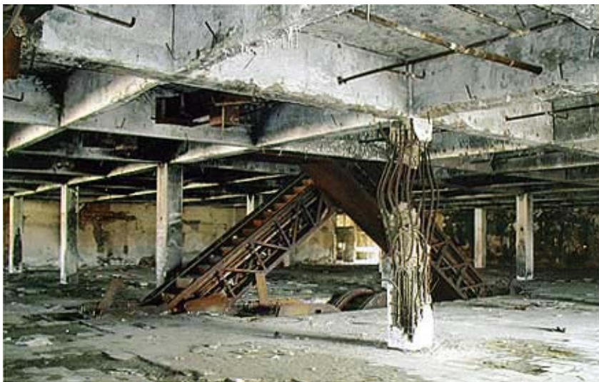
Oštećenja u bivšoj Nami
