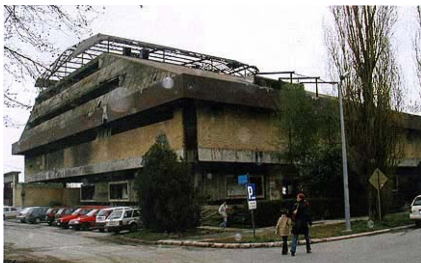
Oštećena zgrada nekadašnje Name
