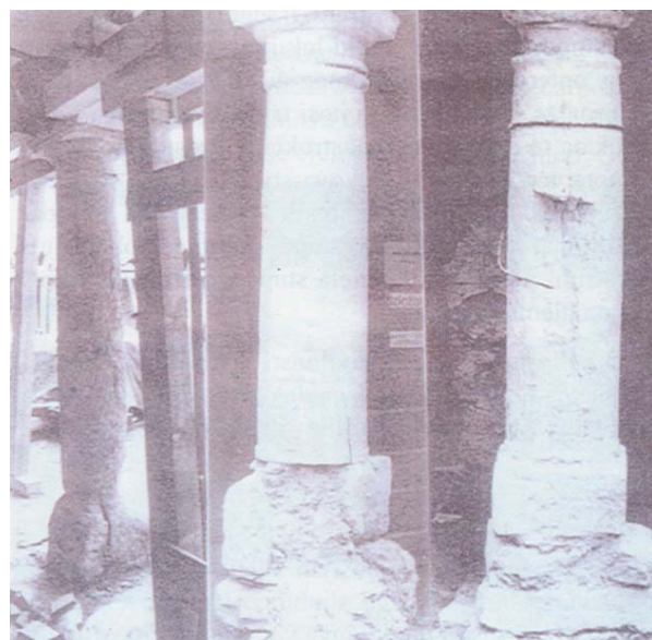
Slika 4. Oštećenja stupova br. 1, 3 i 4
