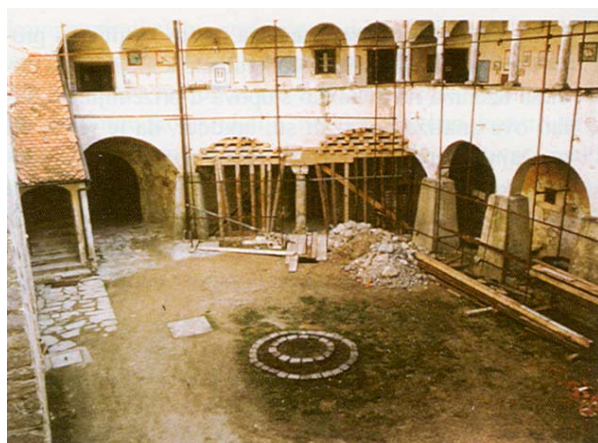
Slika 3. Preventivno podupiranje drvenom skelom uz stup br. 2 i uklanjanje dozida od opeke
