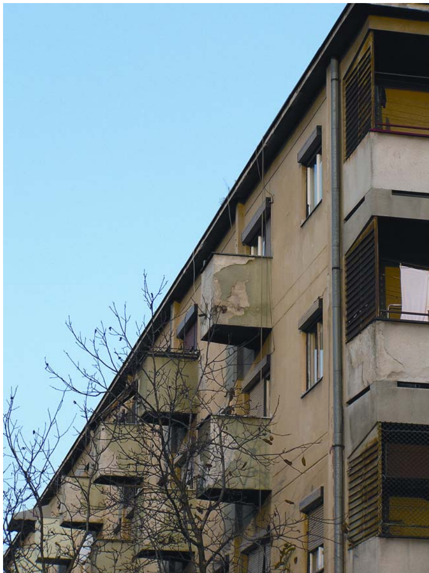
Slika 1. Balkon kojemu je potrebna sanacija
