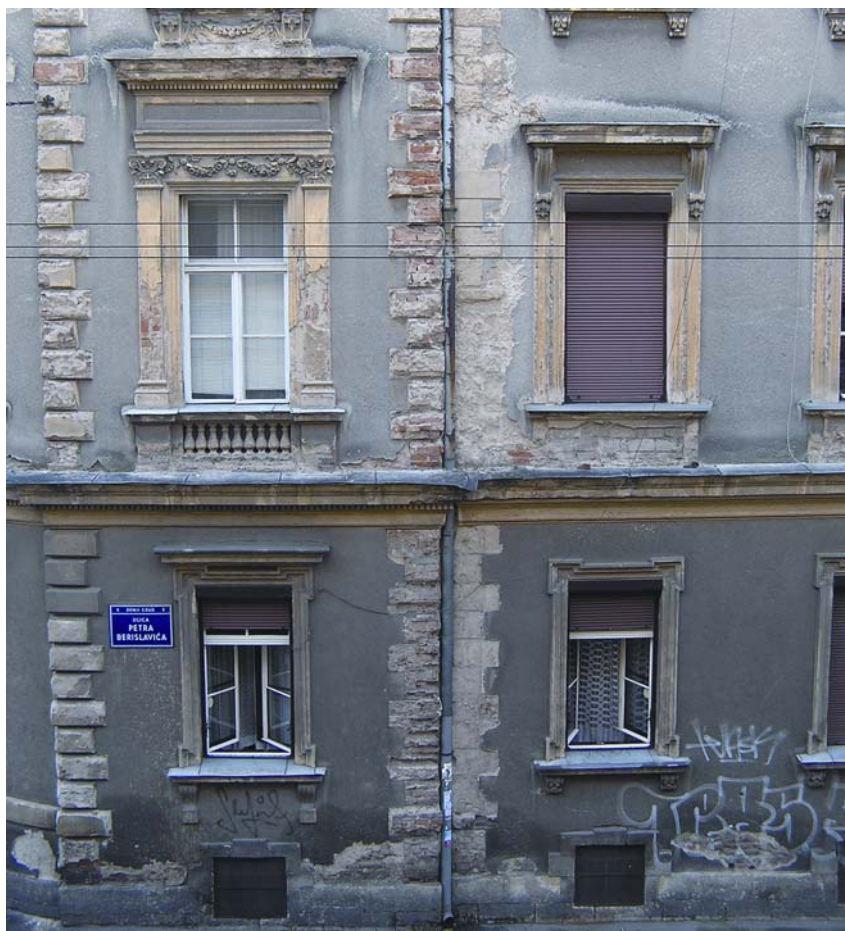
Slika 2. Zgrada u Berislavićevoj ulici 9 kojoj je potrebna sanacija pročelja
