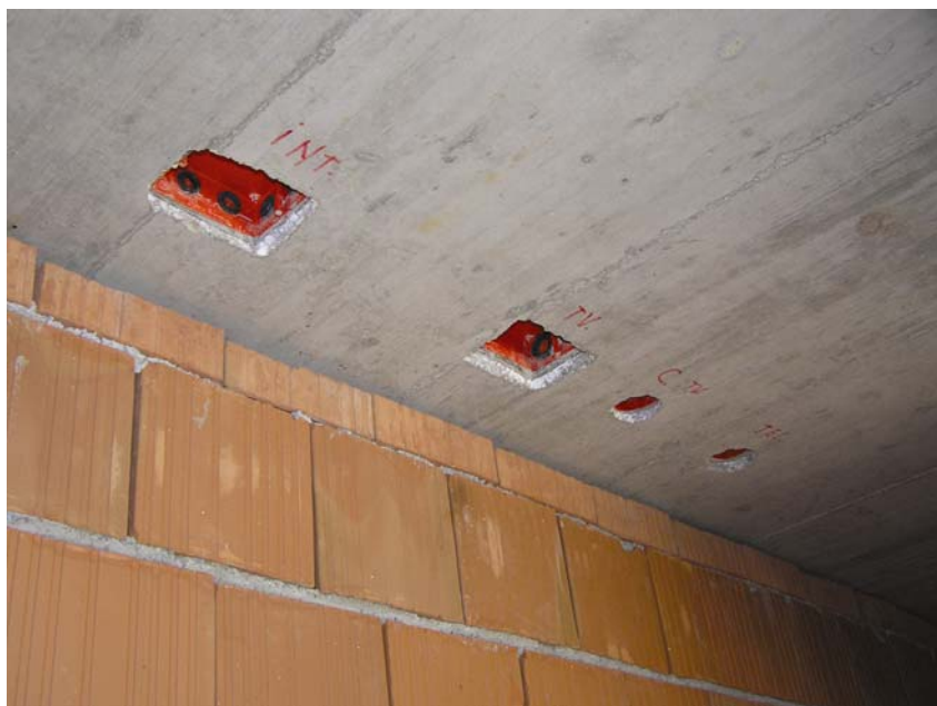
Mjesta u stropu za priključke instalacija
