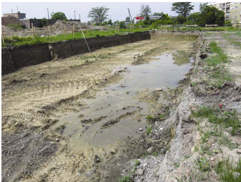
Pojava podzemne vode u građevnoj jami
