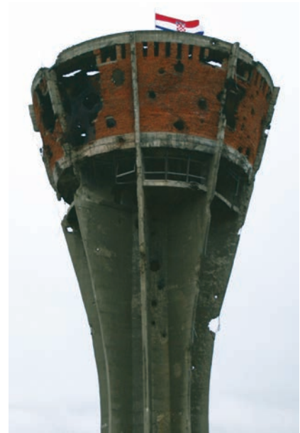
Slavni Vodotoranj s više od 600 oštećenja
