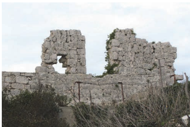
Slika 11. Otvor i dva zupca kruništa na sjevernom zidu, u lijevom zupcu se vidi oštećena strijelnica
