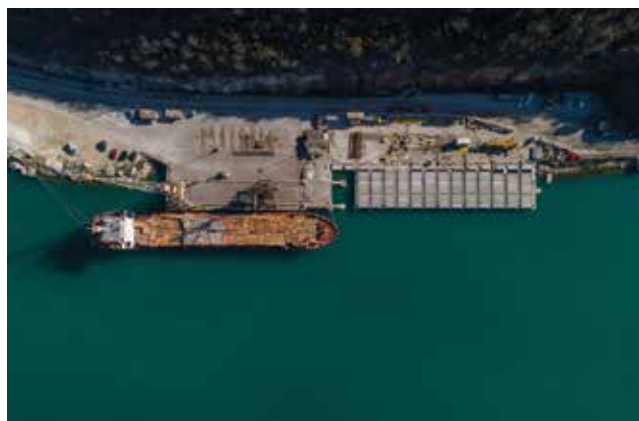
U bazenu Raša, na terminalu za generalne terete u tijeku je rekonstrukcija obale
