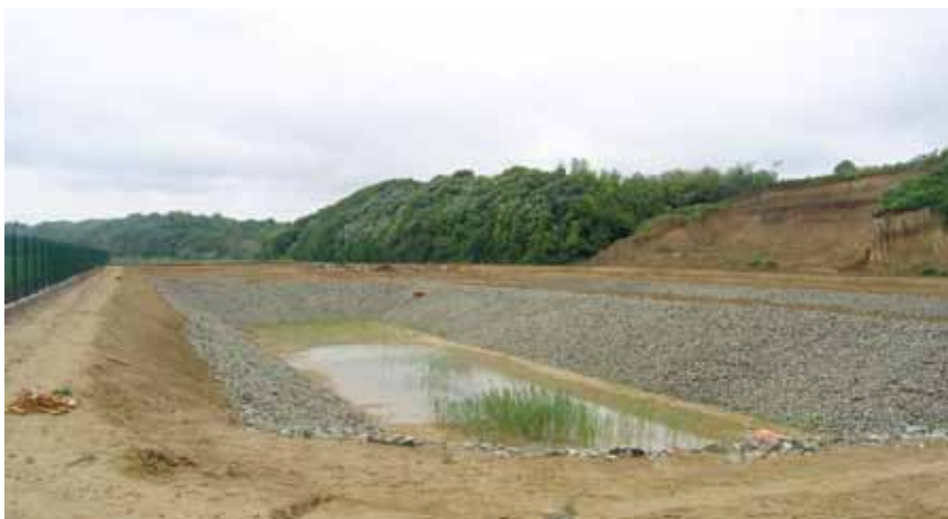
Biologuna za pročišćavanje otpadnih voda
