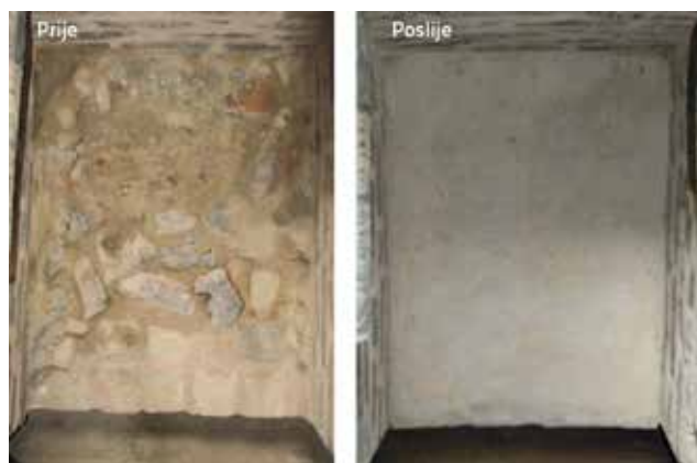
Slika 9. Izgled podne površine prije i poslije konzervatorske obrade [4]
