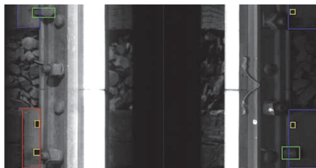
Slika 9. Nadzor površinskih oštećenja kolosijeka - detekcija defekata (nedostajući klinovi) [10]
